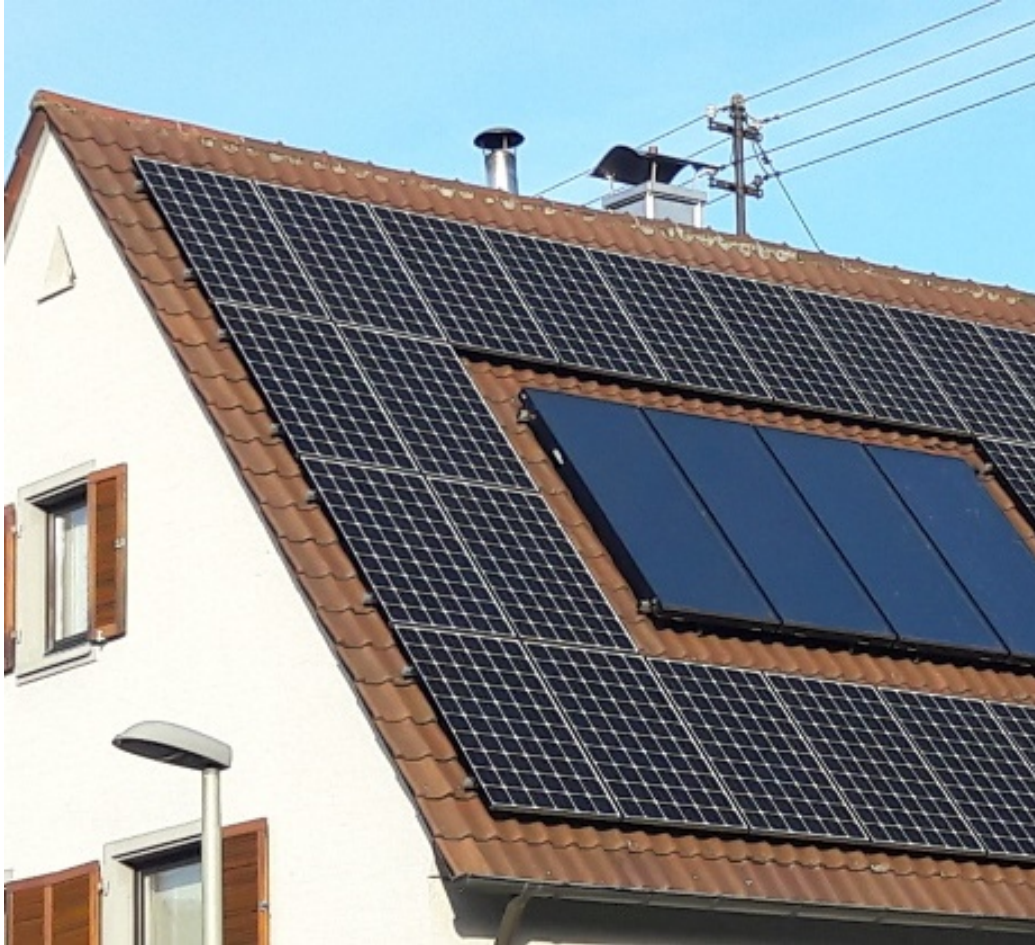
Brauchwasserunterstützung – dezentral für Einzelgebäude, Heizungsunterstützung (außen PV, innen ST, Foto: energie-fachberater.de)
