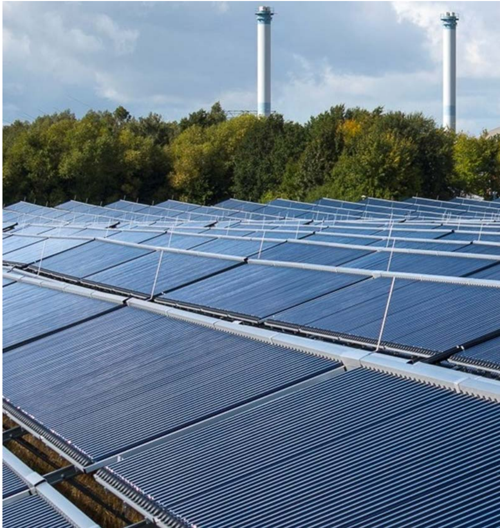
Stadt Greifswald, Vakuumröhrenkollektoren
