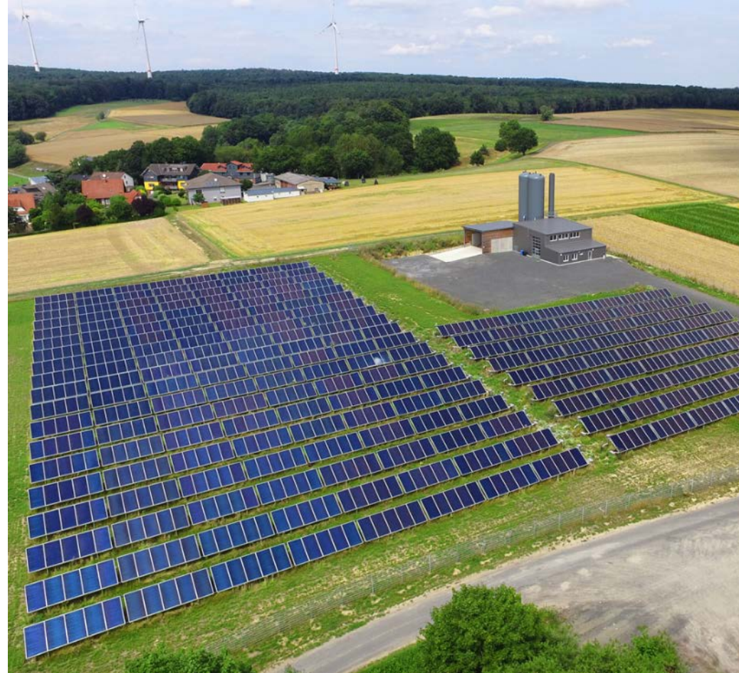
Freiflächensolarthermie 2.950 qm im Sonnen- und Bioenergiedorf Mengersberg (Foto: Mengersberg BEGM eG)
